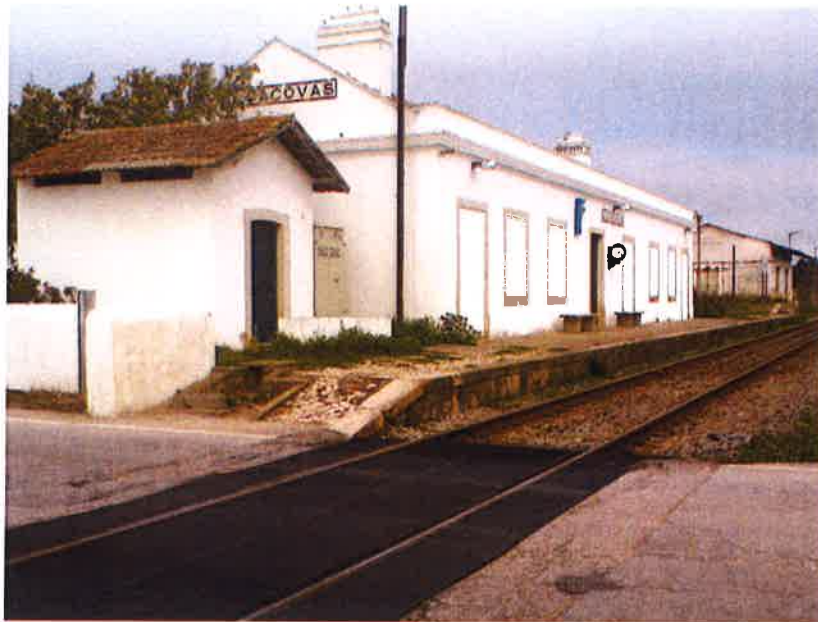
Acesso à plataforma pela Estrada Nacional N380 Ausência de abrigo
